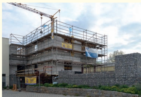
Für die Kinder entsteht ein modernes und funktionales Gebäude mit viel Platz zum Spielen und Toben.
